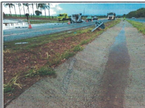
Marcas de fricção na canaleta de drenagem e colisão com placa
